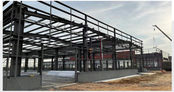
陕西省榆林市BIPV光伏建筑一体化22兆瓦项目展示
