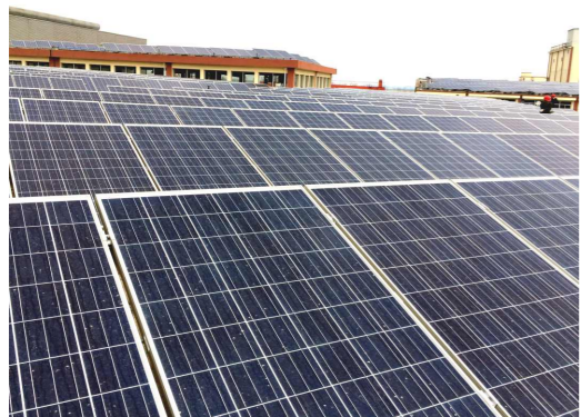
河南濮阳9MW分布式光伏电站
