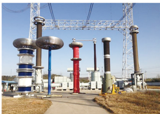
1000kV 晋东南 - 南阳 - 荆门 GIS PT 误差检测
