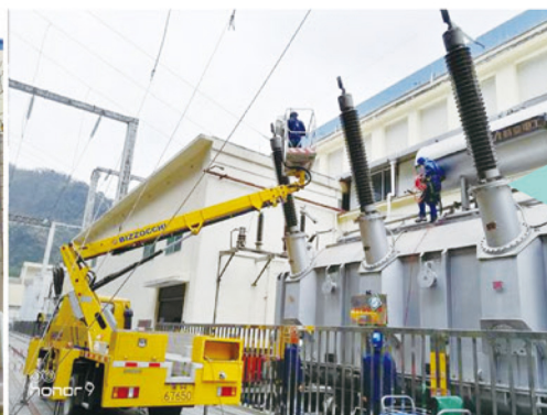
变压器维护检修试验
