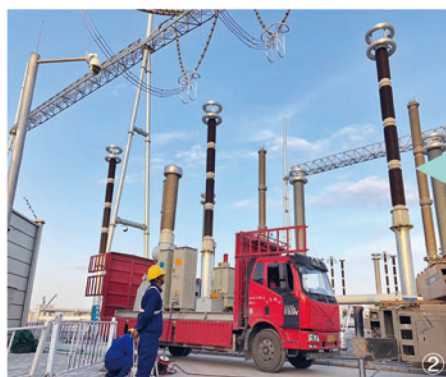
① 1000kV 车载平台 CVT 误差检测
