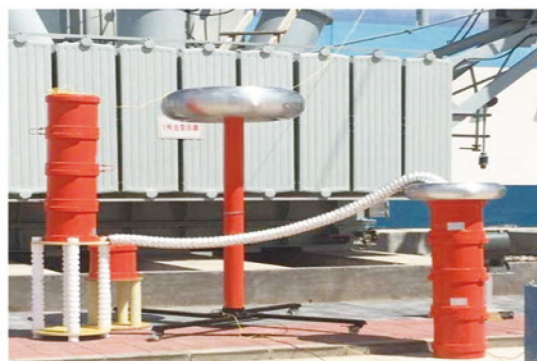
十里泉发电厂 220KV 变压器耐压
