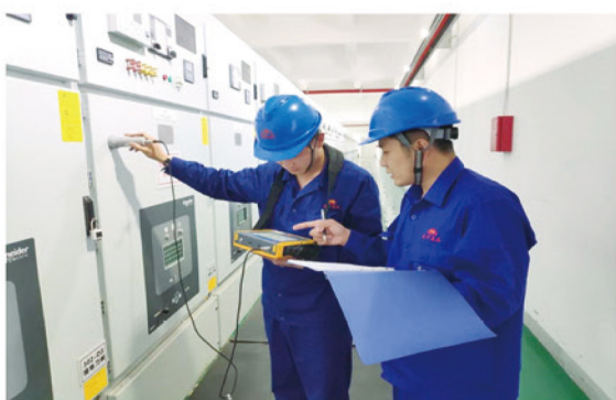
山东临沂 110kV 三和站开关柜带电检测
