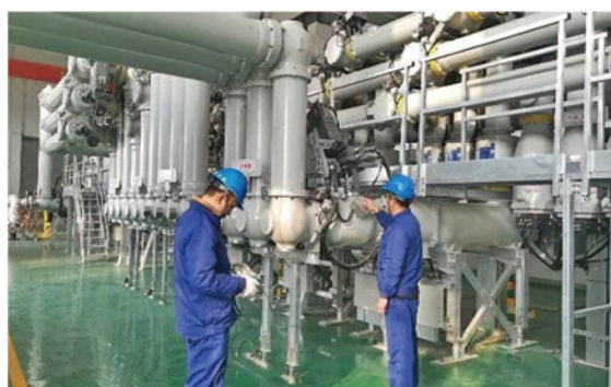
山东威海 220kV 文登变组合电器带电检测
