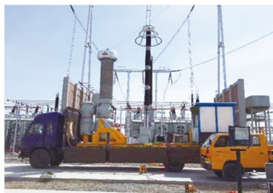
新疆西山 750kV CVT 误差试验
