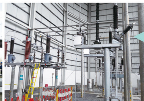
整站检修预防性试验
