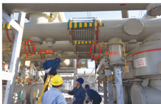
山东临沂 110kV 桃园变组合电器带电检测
