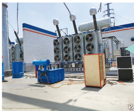
① 500kV 变压器现场耐压
