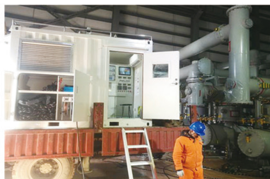
阿里联网工程巴尔站 220kV CT 误差校准试验
