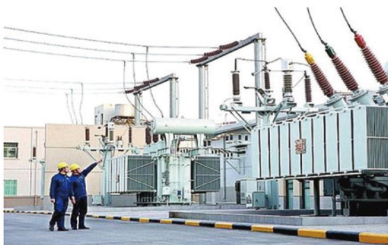
山东日照钢铁 220kV 变电站带电检测
