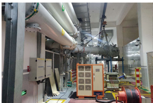
浙江仙居地下水电站 550kV GIS 耐压试验
