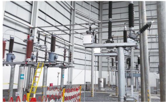
冀北技培中心变电检修实训室培训设施改造
