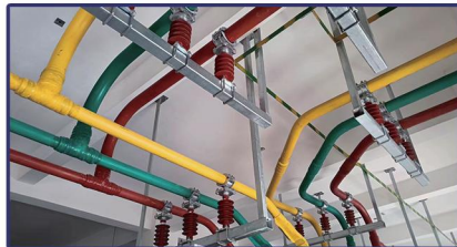
华能营口热电公司全绝缘管母项目
