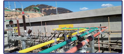
四川凉山会理光伏发电项目
