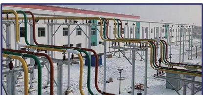
新疆甘泉堡增量配电网220kV甘六变电站
