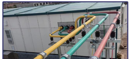
西宁南川绿电配售电有限公司东沟滩110kV输变电工程
