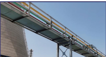
宁夏晶体新能源材料有限公司余热发电项目
