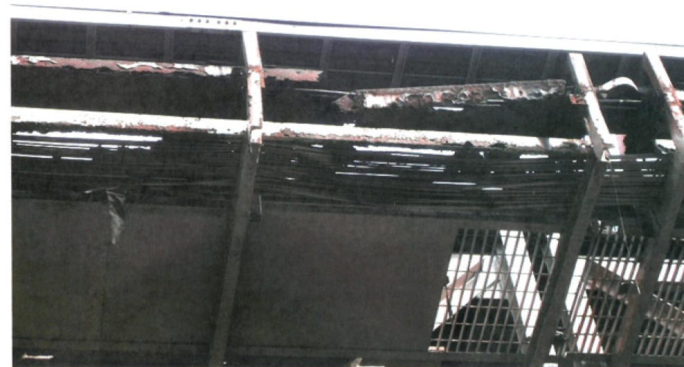
腐烂钢质电缆桥架
