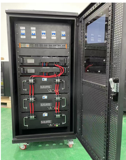
某某公安局应急配电系统
